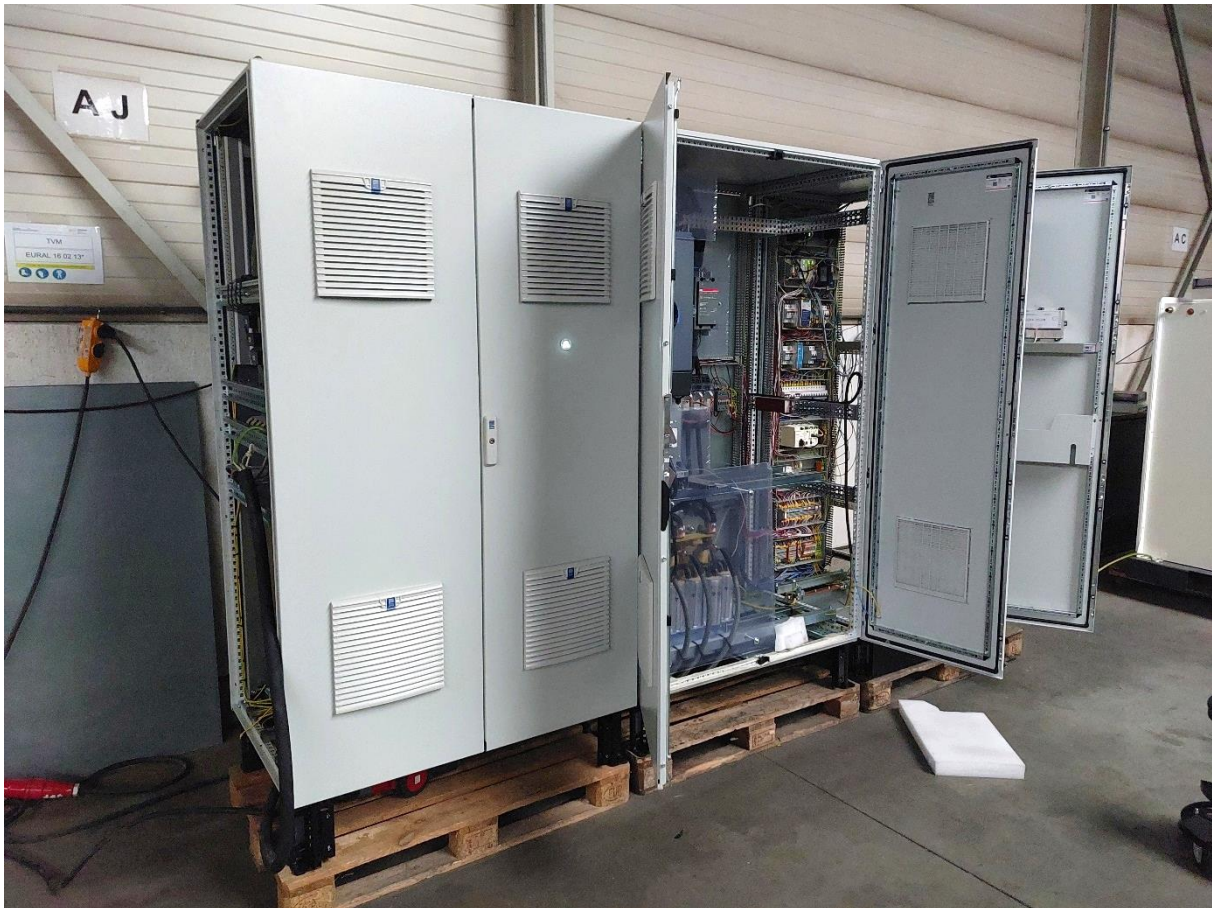
Image 2: Armoire de conversion de puissance et de contrôle sous construction
